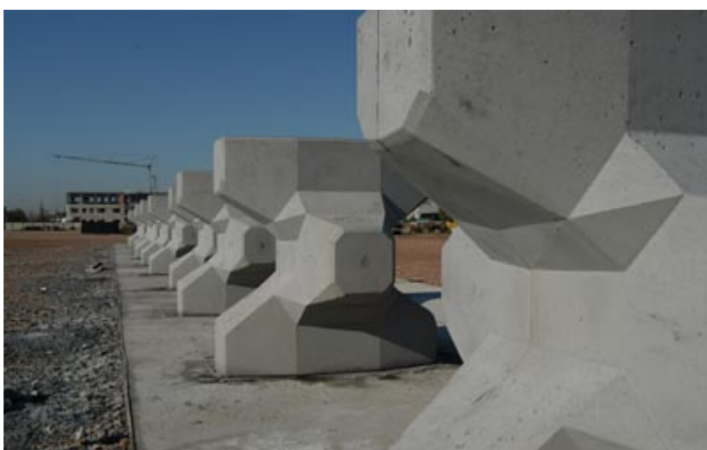
Fusina: Realizzazione degli acropodi impiegati nella costruzione della scogliera alla bocca di porto di Malamocco
