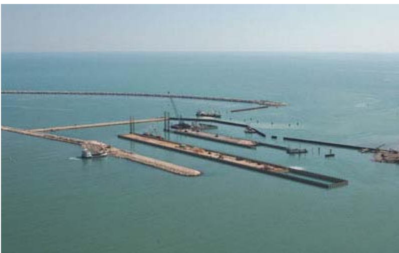
Aprile 2006: il bacino formato dal palancoato e dal pennello in pietrame perpendicolare al molo, strutture provvisorie che verranno rimosse al termine degli interventi
